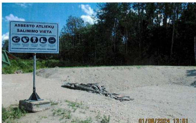
26 pav. Asbesto turinčių atliekų šalinimo sekcija
